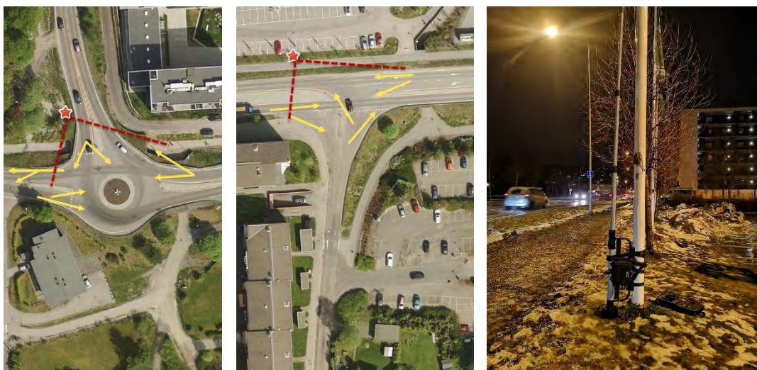
FIGUR 23 Nye trafikktellinger i rundkjøring og T-kryss langs fylkesvegen (redigert flyfoto fra kart.1881.no). Bildet til venstre viser ferdig montert teleutstyr ved T-kryss med Tunveien (EFLA AS).
