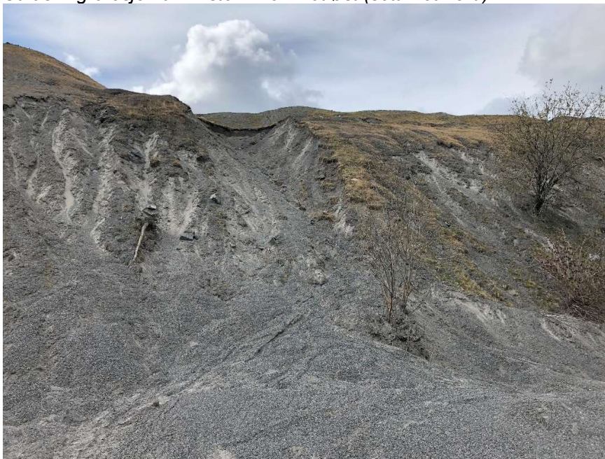
Utvasking/erosjon av finstoff i voll mot øst (sett mot vest)
