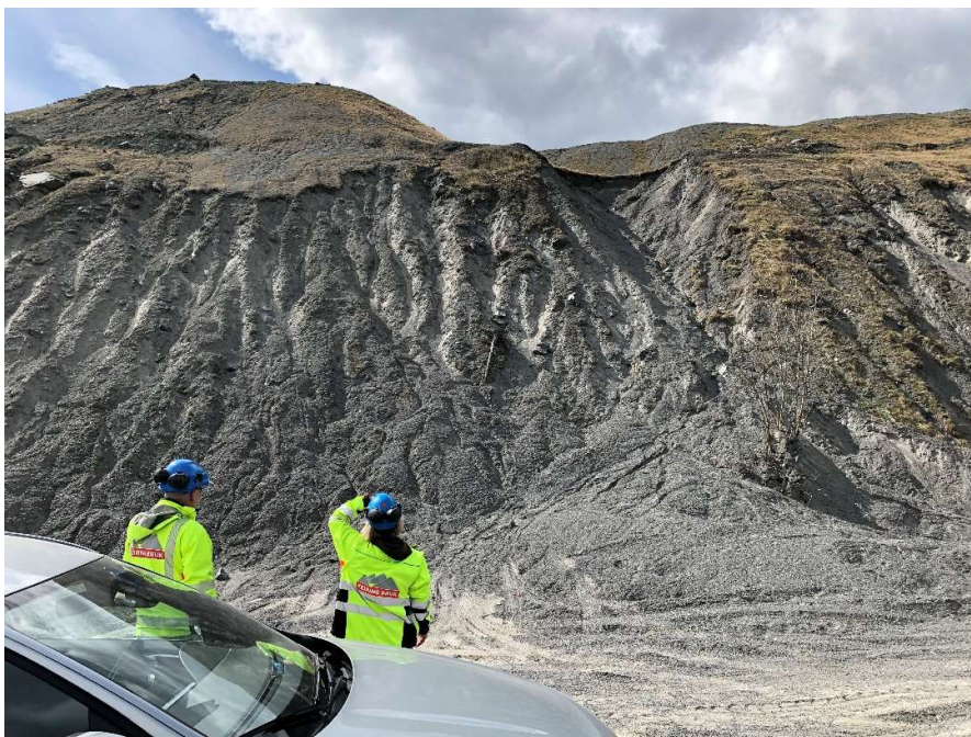
Erosjonsskader i finstoffvoll mot øst (sett mot vest)
