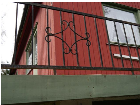
Fig 19 - Ringveien 3, verandarekkverk. Foto: Siv Leden, NIKU 2016
