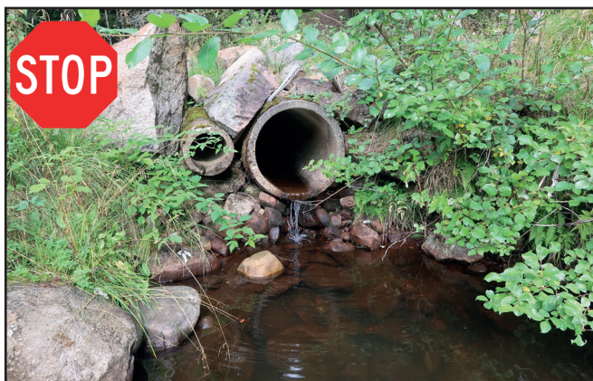
Bilde 2: Legges rørene slik, skapes unødvendig stengsel for oppvandrende gytefisk. Bildet viser en gytebekk som er sterkt forringet fordi røret er lagt feil.
