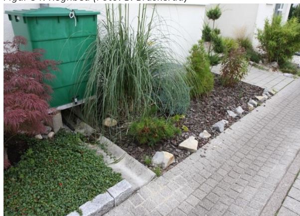
Figur 36: Taknedløp ført i en cisterne, med renne som overløp (Foto: Erling Holm ©)
