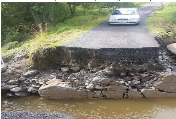
Figur 5: Vålerveien ble tatt av vannmassene (Foto: Lasse Smith)
