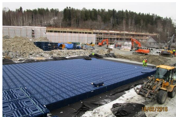
Figur 60: Fordrøyningsbasseng av plastkassetter på Luhr skole, Lørenskog (Foto: Hent AS)
