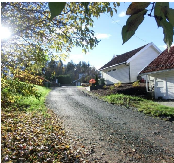
Figur 23: Manglende grøfter i Lysåskroken, Lørenskog (Foto: Yvona Holbein)
