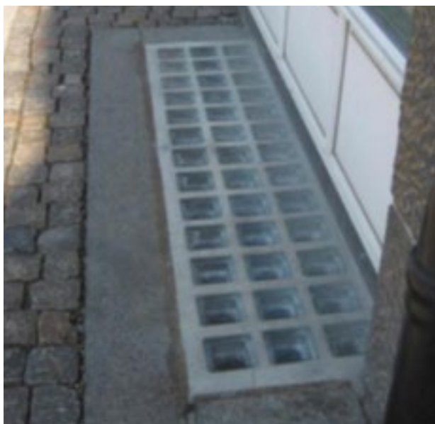
Lyskasser kan også lukkes til med glassten eller annet robust gjennomsiktig materiale. Som en midlertidig sikring kan den også overdekkes med en plate. Foto: Rørcenteranvisning 020
