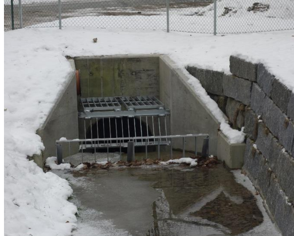
Figur 81: Selvrensende innløpsarrangement i Solbergbekken, Bærum kommune (Foto: Yvona Holbein)
