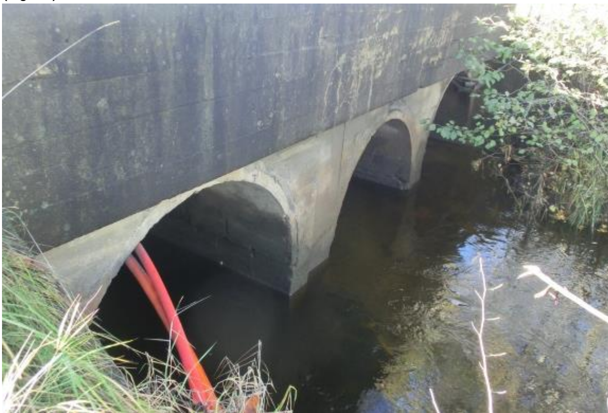
Figur 5: Begrenset kapasitet på kulverten under Solheimsveien medfører oppstuvning av Ellingsrudelva (Foto: Yvona Holbein, Lørenskog kommune, 2015).
