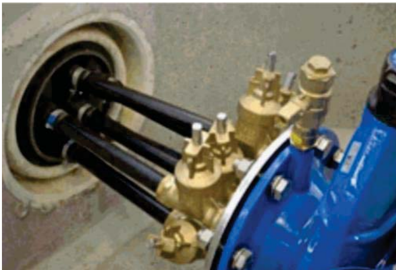
Figur 9. Eksempel på stikkledninger som ligger buntet sammen
