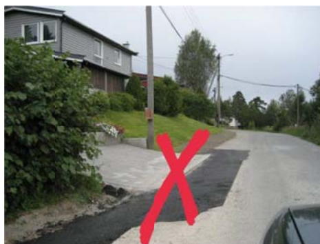
Uønsket endring av grøftetrasé
