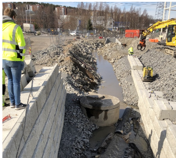
Utslippskum ved Bertel O. Steen står plutselig i løpet til Røykåsbekken (foto: Anette Hansen)
