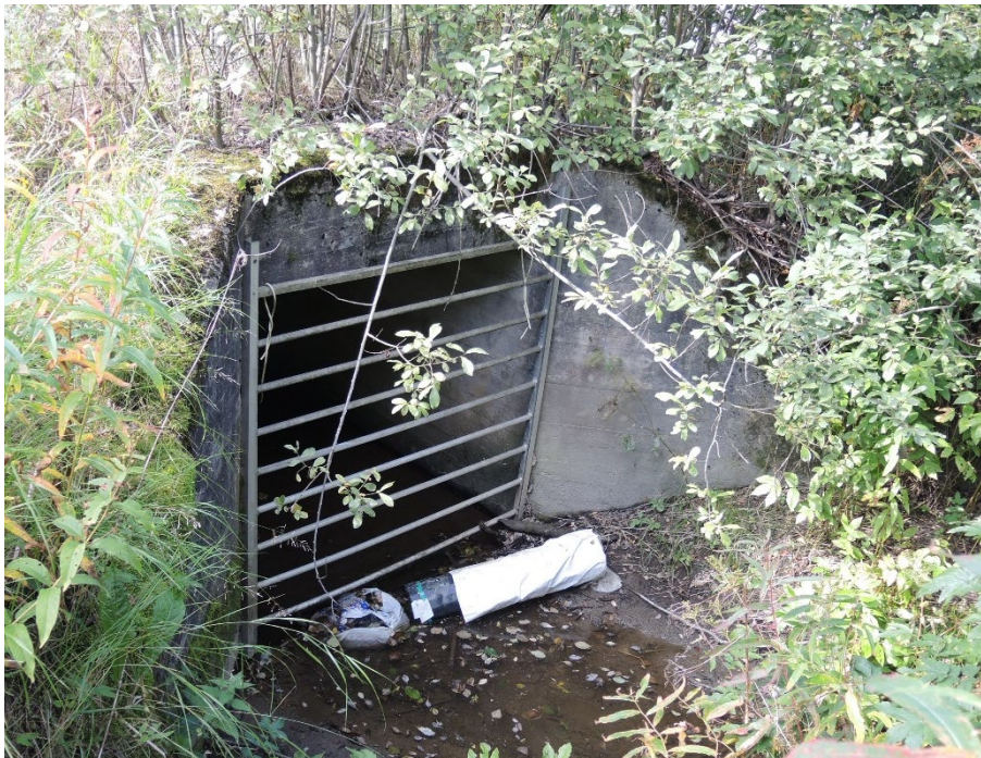
Bekkeinntak for Djupdalsbekken v/Lørenskog stasjon (foto: Y. Holbein)
