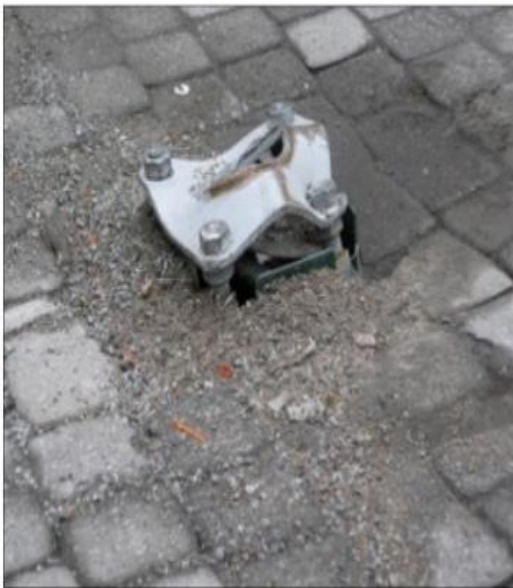
Manglende sikring/varsling av mastefundament medfører fare for å snuble.
