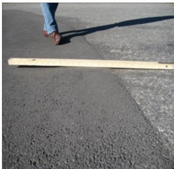
Nivåsprang mellom nytt og gammelt veidekke
