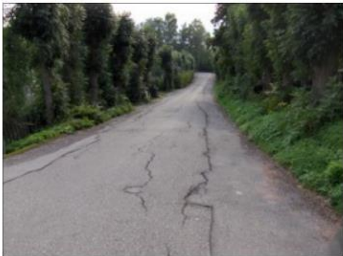
Langsgående sprekker i asfaltdekke.
